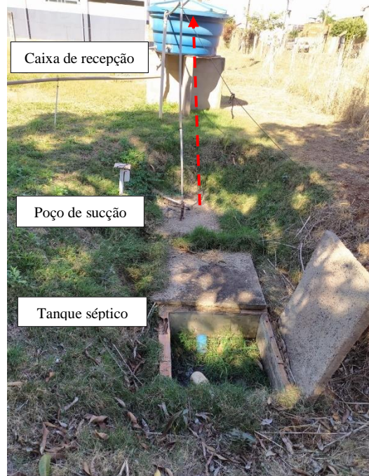
Figura 4.3 - Tanque séptico, poço de sucção e caixa de recepção.
